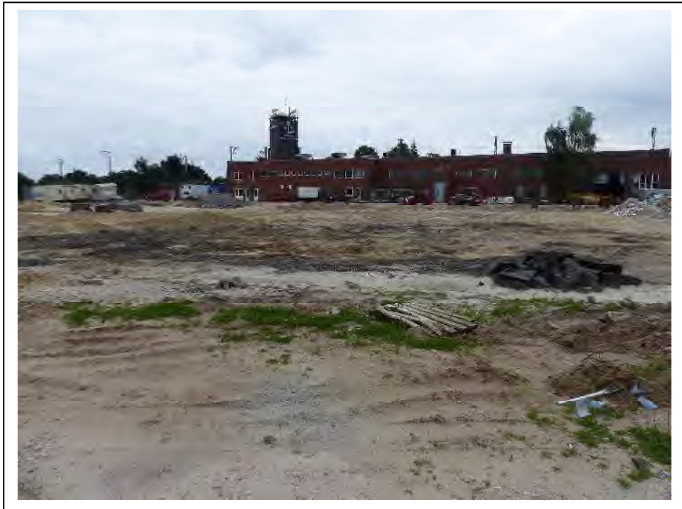
Foto 3: Wie vor, Blickrichtung verändert. Hier wurden die Lagerhallen, welche z.T. auch als Waschhallen verwendet wurden, bereits abgebrochen. Blickrichtung Osten (12.06.2018).
